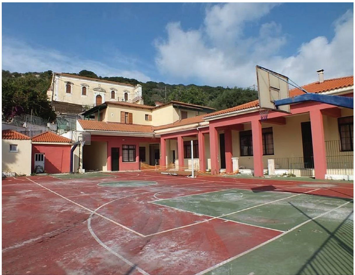
Εικόνα 3. Το κτίριο του Γυμνασίου της Αγ. Θέκης, εγκαταδεδειμμένο μετά τους σεισμούς του 2014.
